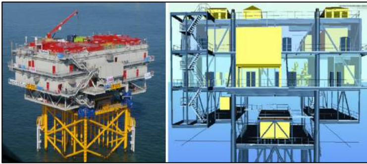
Şekil 11.23. Thornton Bank DRES denizüstü şalt sahası.
