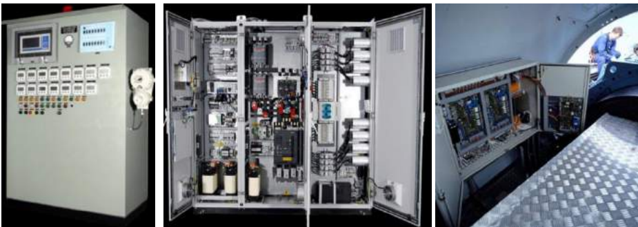
Şekil 5.17. RT kontrol paneli.
