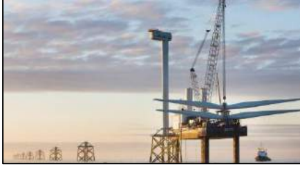
Şekil 10.57. Ormonde DRES montajı.
