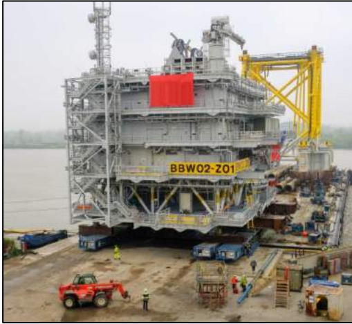
Şekil 10.31. DRES denizüstü şalt sahası gemiye yüklenme.
