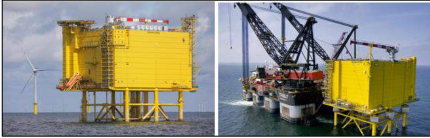
Şekil 9.20. Borkum Riffgrund DRES şalt sahası.
