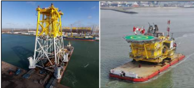
Şekil 5.58. DRES şalt sahası alt ve üst yapı.
