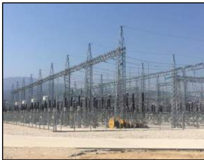
Şekil 5.60. DRES şebeke girişi (trafo merkezi).
