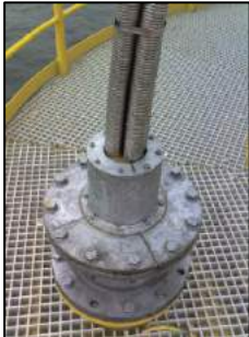
Şekil 11.21. Platform üzerinden J-tube'den geçen kablo.
