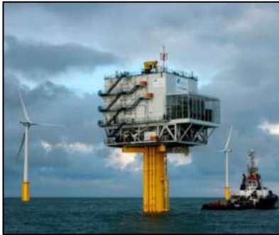
Şekil 10.63. Montajı bitirilmiş denizüstü şalt sahası.
