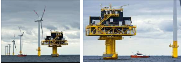
Şekil 5.56. DRES şalt sahası.
