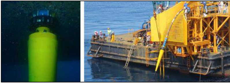
Şekil 9.34. Harada DRES projesi DRT kablolama.
