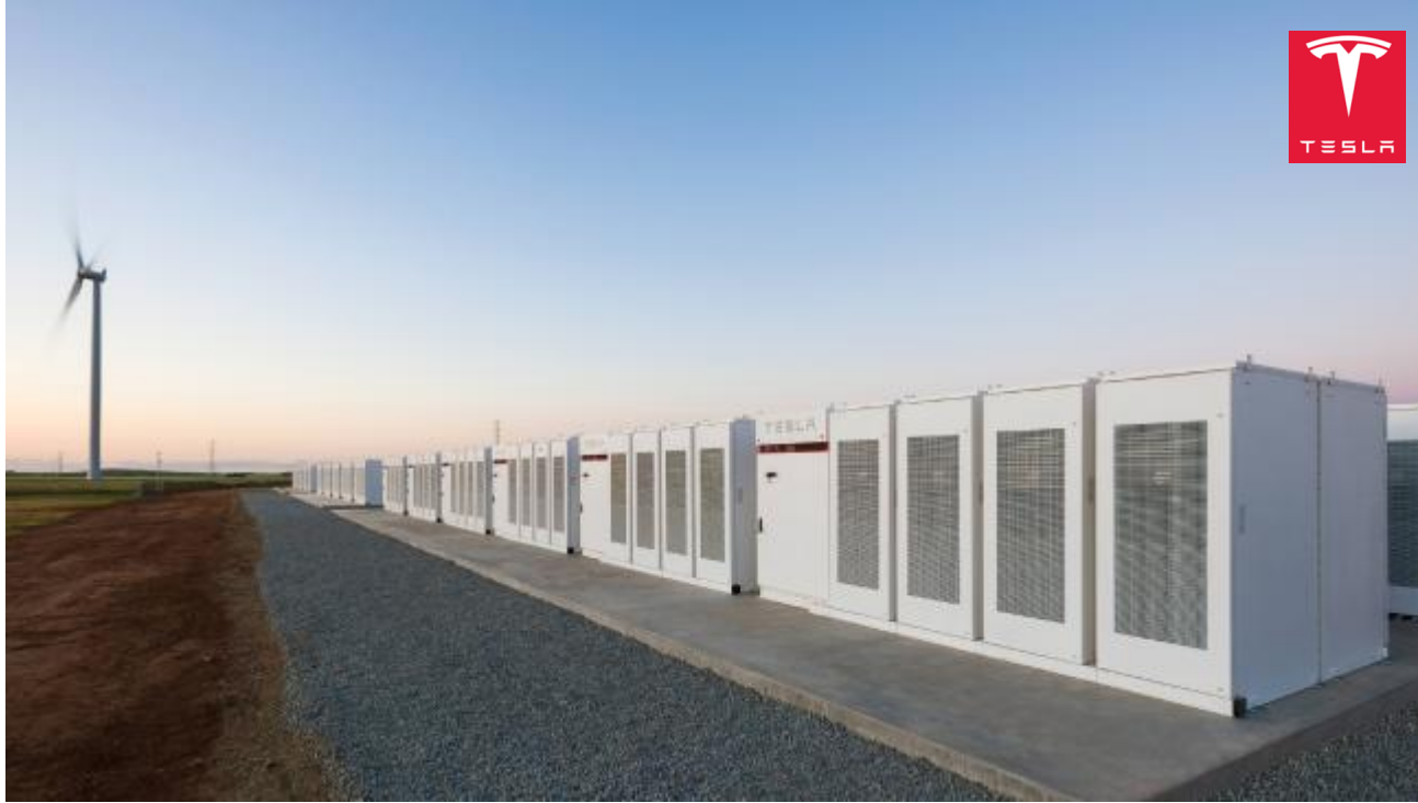
Tesla Avustralya 100 MW Li- Ion Batarya Depolama Sistemi
